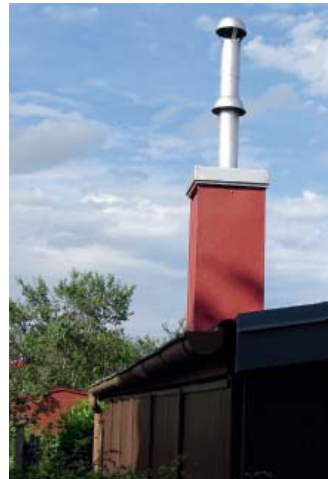
Durch die umfassende Sanierung bzw. den Austausch von Bauteilen bei diesem Schornstein dürfte der Bestandsschutz verloren gegangen sein.
