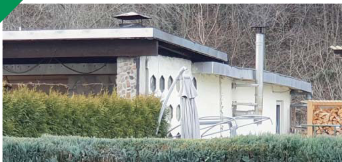
Sowohl der Edelstahlschornstein an dieser Gartenlaube als auch die errichtete Freisitzüberdachung verstoßen offensichtlich gegen das Bundeskleingartengesetz und die Rahmenkleingartenordnung. Hier besteht Handlungsbedarf.
